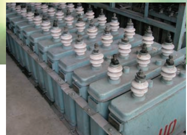
転倒防止措置をして保管されているトランス
