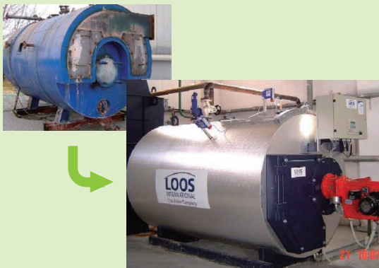
高効率ボイラーの導入(YKKギリシャ社)
