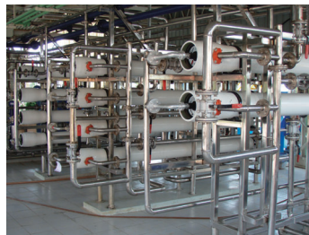
逆浸透膜(NF)モジュール
